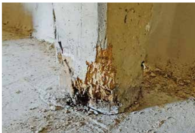
Nicht jede Schwachstelle ist ein Bergschaden: Wurmfraß an einer Emporenstütze
