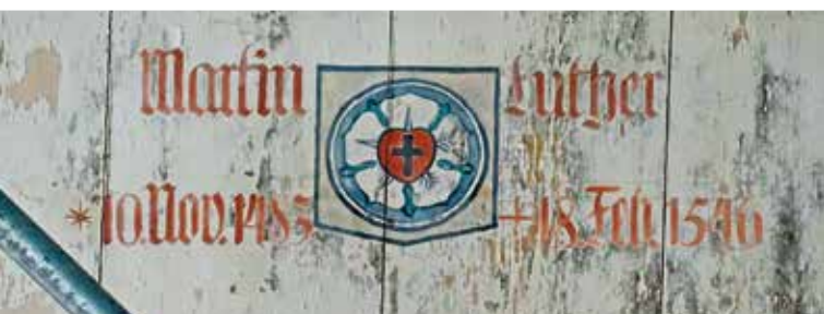
Die Farbe blättert, das Bekenntnis steht: Brüstungstafel an der Empore
